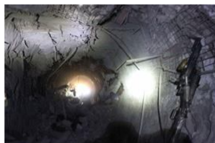
(b) 巷道顶板破坏情况
