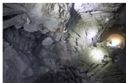
(a) 巷道两帮破坏情况
